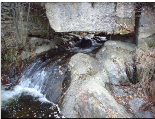
N°38 : En aval du Pont de Coma Pregonan : Aval de l'ancien pont (moy. eaux)
